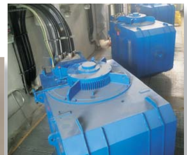
1200 PS Motor der Zulaufpumpen
